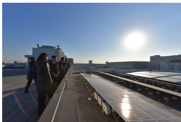
通用技术机床所属机床研究院工研精机建成装机容量约1.8MW、年均发电量为190.70万kW·h的光伏自发电项目
